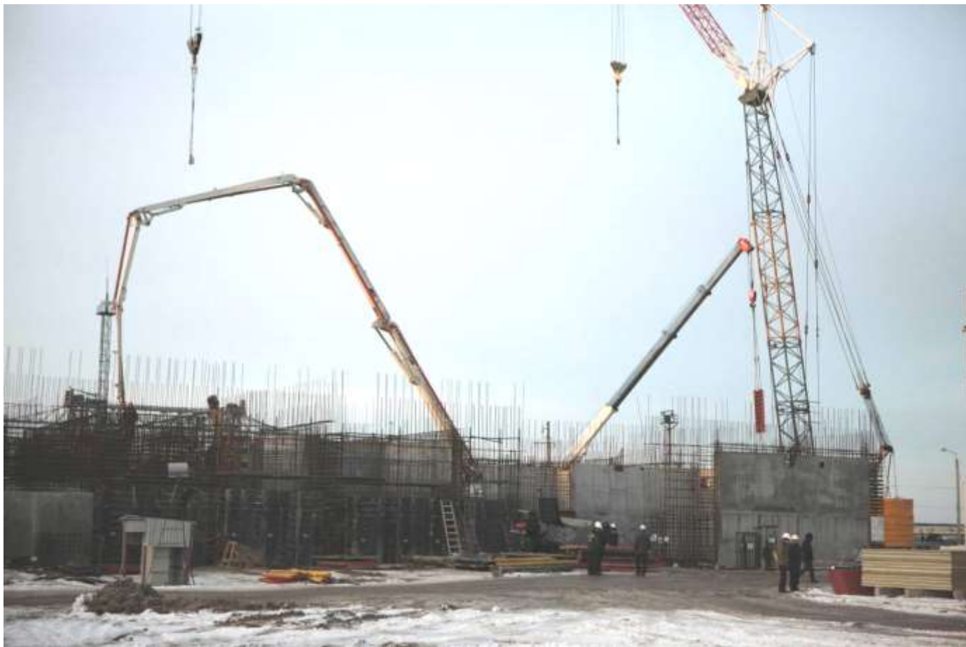
Комплекс по переработке твердых радиоактивных отходов
