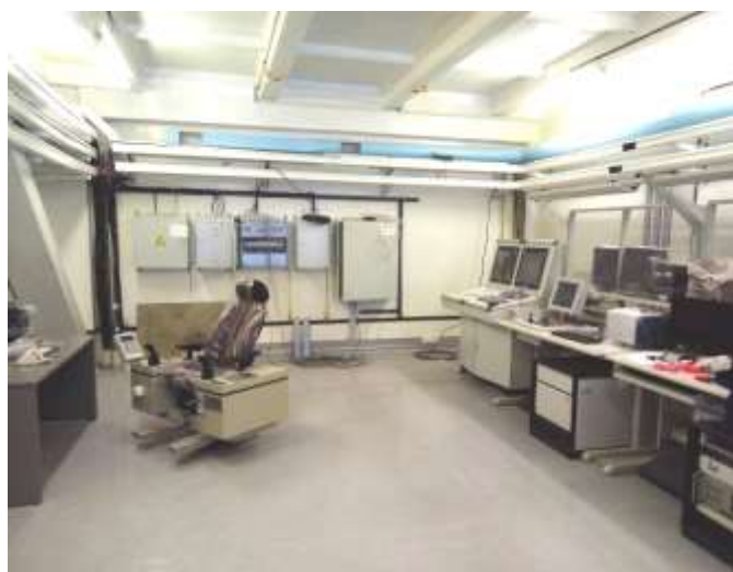
ХТРО-III Помещение АСУ ТП
